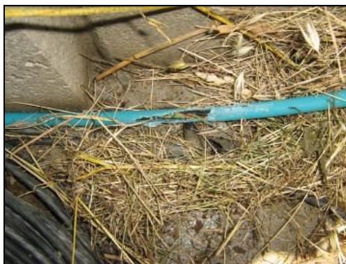
Fig. B.3 - Guasto a una linea di telecomunicazione provocato da attacco di roditori
