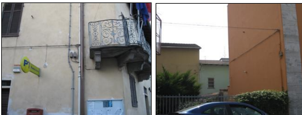
Fig. B.18 - Esempi reali di cablaggio in facciata di edificio
